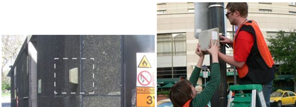
Figura 28 - Scanners de bluetooth sendo instalados na cidade.
